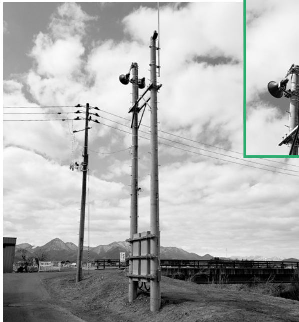
令和7年に設置された「警報よびかけ塔」
